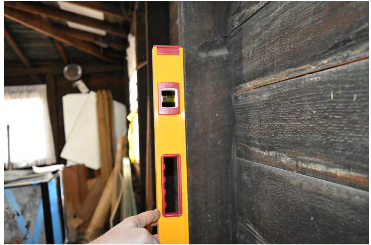
2 6 Exterior wall // stud wall out of plumb
