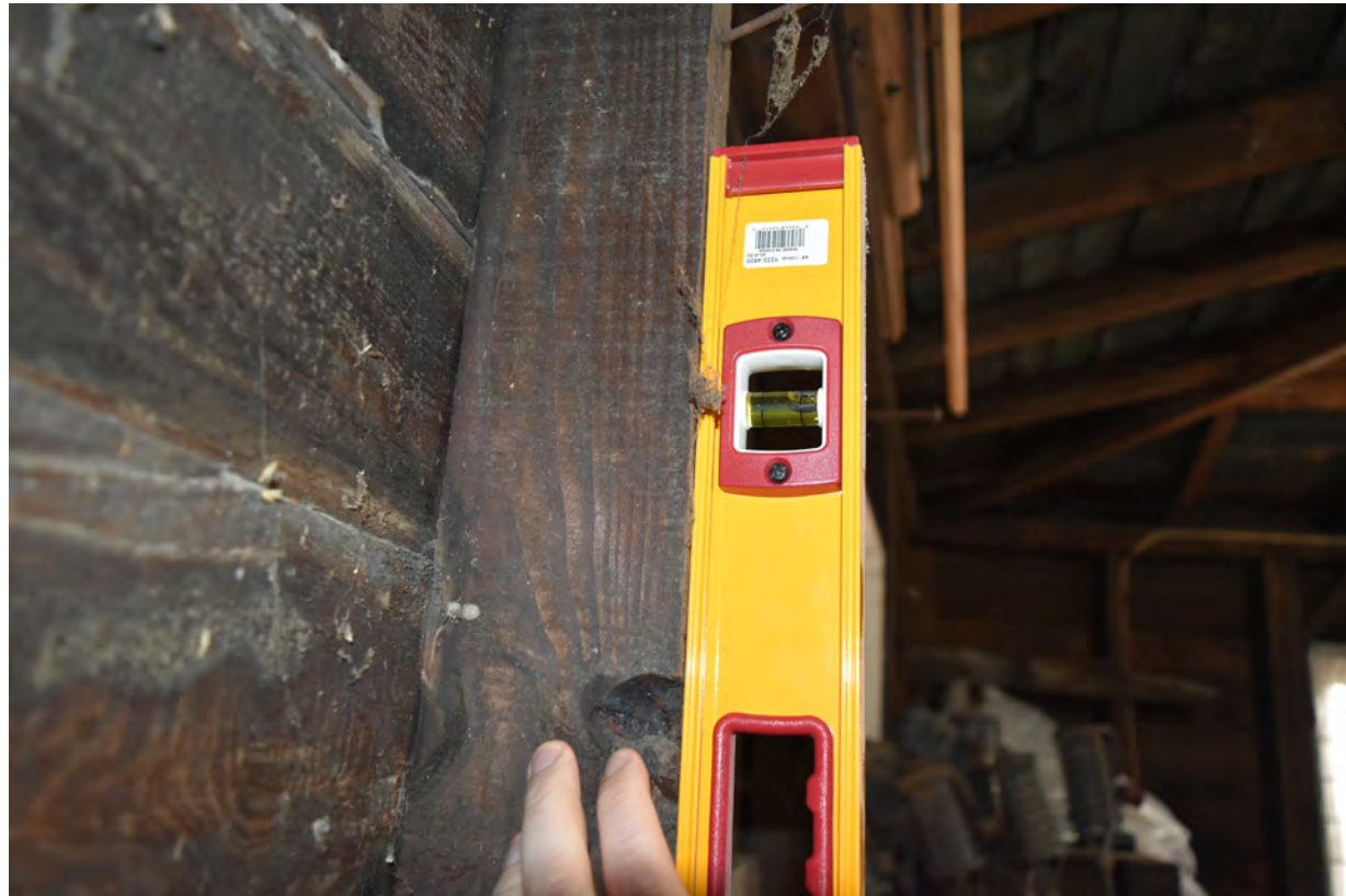
3 6 Exterior wall // stud wall out of plumb
